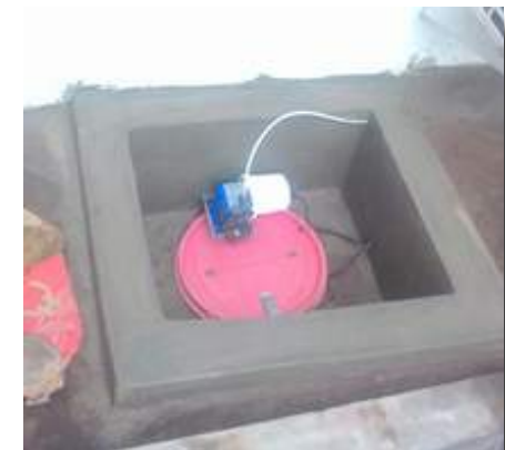
Penambahan chlorinasi pada sumur gedung baru. Menggunakan dozing pump.
